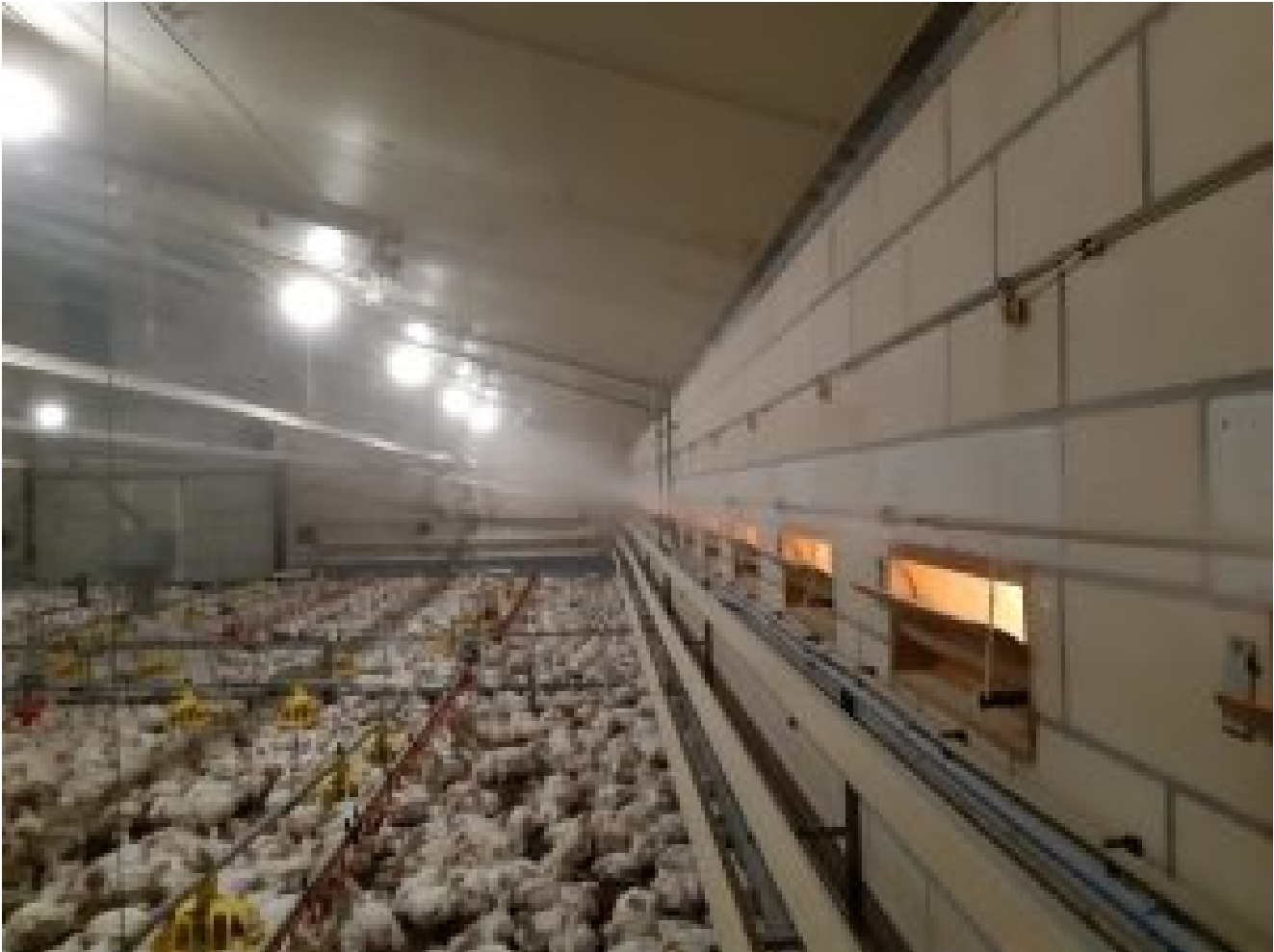
Vernevelingsinstallatie in de vleeskippenstal (foto Proefbedrijf Pluimveehouderij)
