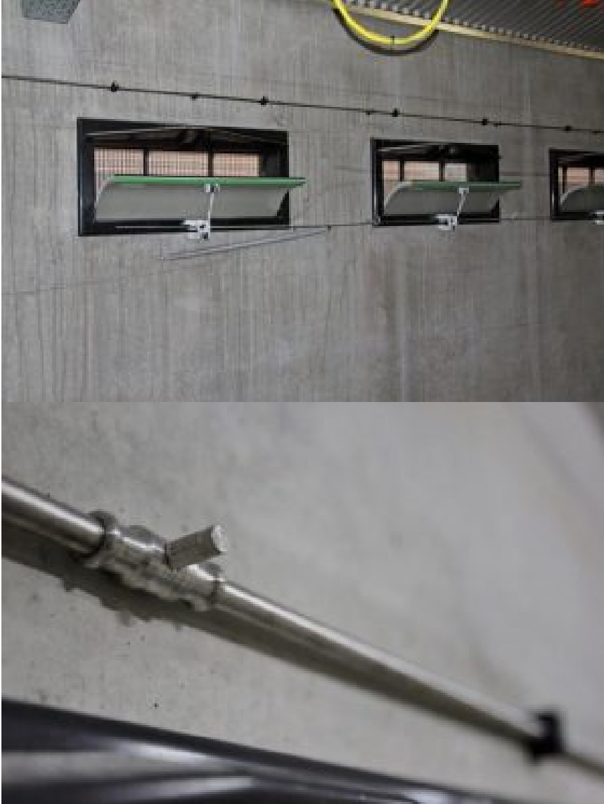
Nevelkoeling met spraynozzles ter hoogte van de luchtinlaatventielen (Foto Proefbedrijf Pluimveehouderij)
