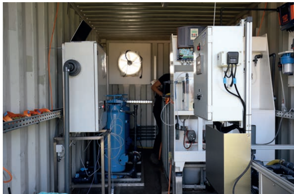
Rechts de doseringsunit voor chloordioxide van Aqua Ecologic. Links de basisopstelling met het zandfilter, de actieve koolstoffilter en de Hortiplan injectie-unit voor peroxide.
