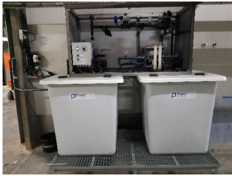
Figuur 4: Behandelingsinstallatie van regenwater op basis van nano-filtratie.
